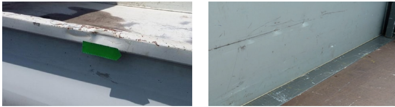
Leichte Kratzer, Schienenverformungen mit Reparaturzeit \leq 1 h
